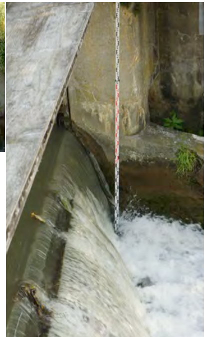
Abb. 5.3.4: Der Absturz unterhalb des Wehrschützes ist über einen Meter hoch und führt auf eine Betonplatte.
