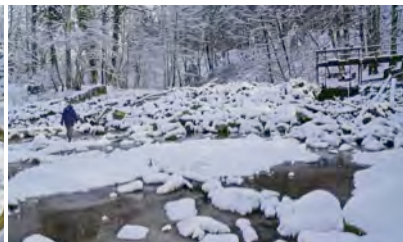
Abb. 5.6.2: Wehr, Situation 2017. Durch die neue Blockrampe und Verklautungen ist kein Fischabstieg mehr möglich.
