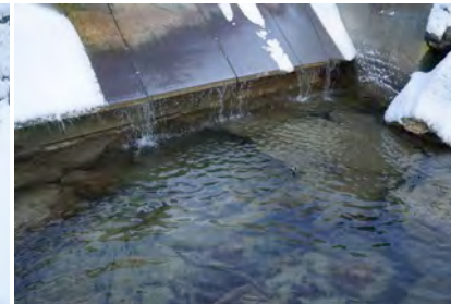
Abb. 5.4.3: Abweiser an den Wehroberkanten. Betonreste im Unterwasser.
