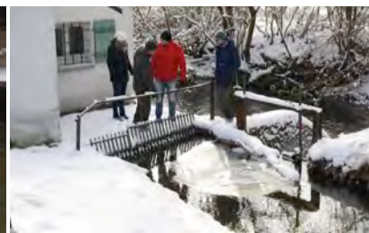
Abb. 5.6.6: Grobrechen und Absturz in die Rotach an der KW-Stufe 2.
