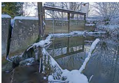
Abb. 5.4.4: Schieber zum Oberwasserkanal.
