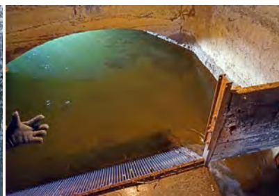
Abb. 5.4.5: Kraftwerkhaus mit Rechen und Entlastungsrinne mit Schieber (rechts).
