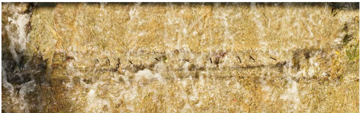
Abb. 5.3.7: Aus der Holzarmierung der Betonrampe herausragende alte Nägel.
