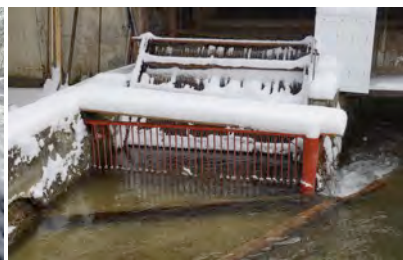
Abb. 5.6.5: Grob- und Rechen (> 20 mm Stababstand) an der KW-Stufe 1.
